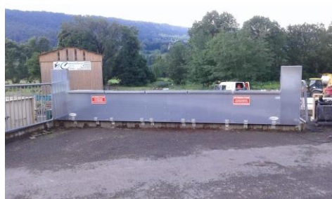
Équipement anti chute de tous les quais
